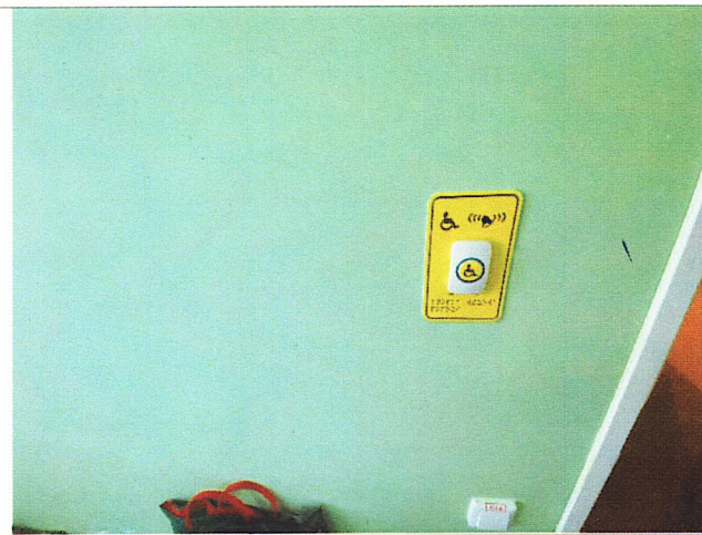
Фото №36 – Кнопка экстренной помощи, установлена в каждой палате.
